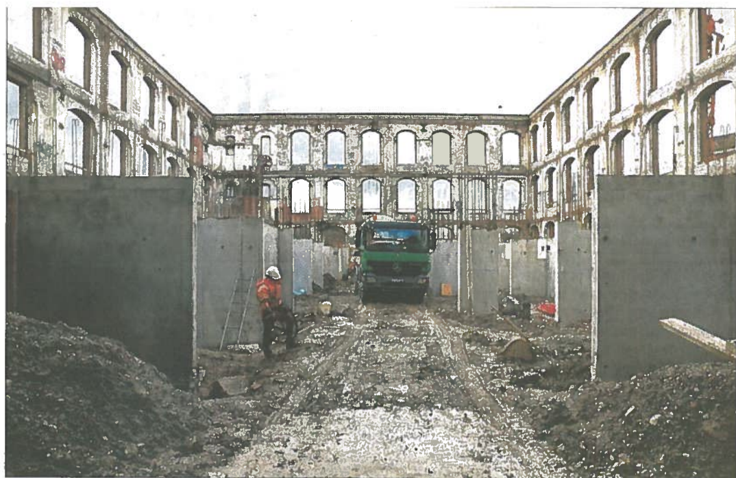
Le gros œuvre est déjà presque terminé au rez-de-chaussée. La dalle de béton du premier étage sera normalement posée d'ici fin février. La fin de chantier est prévue pour décembre prochain.
